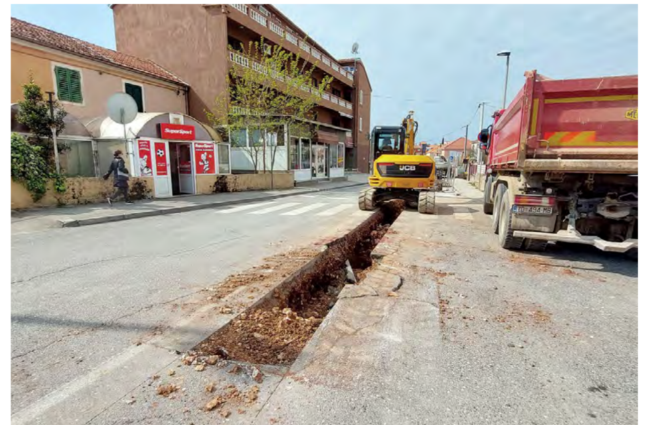
Pogled na kanal u ulici Put Kotlara (foto: L. Bogdanić) View of the channel in Put Kotlara Street (photo: L. Bogdanić)
