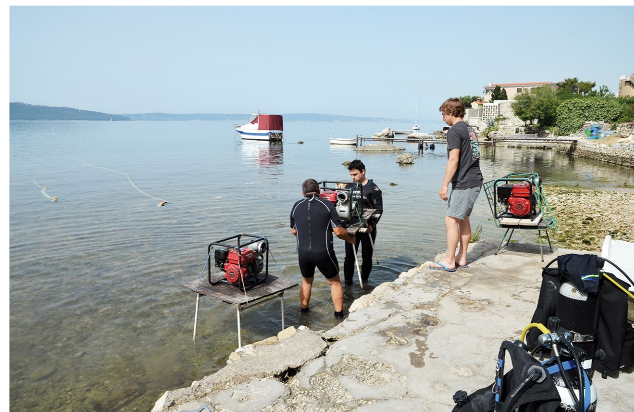
Priprema pumpi za pokretanje vodenih sisaljki (foto: J. Glamač) Preparation of pumps for starting water dredges (photo: J. Glamač)
