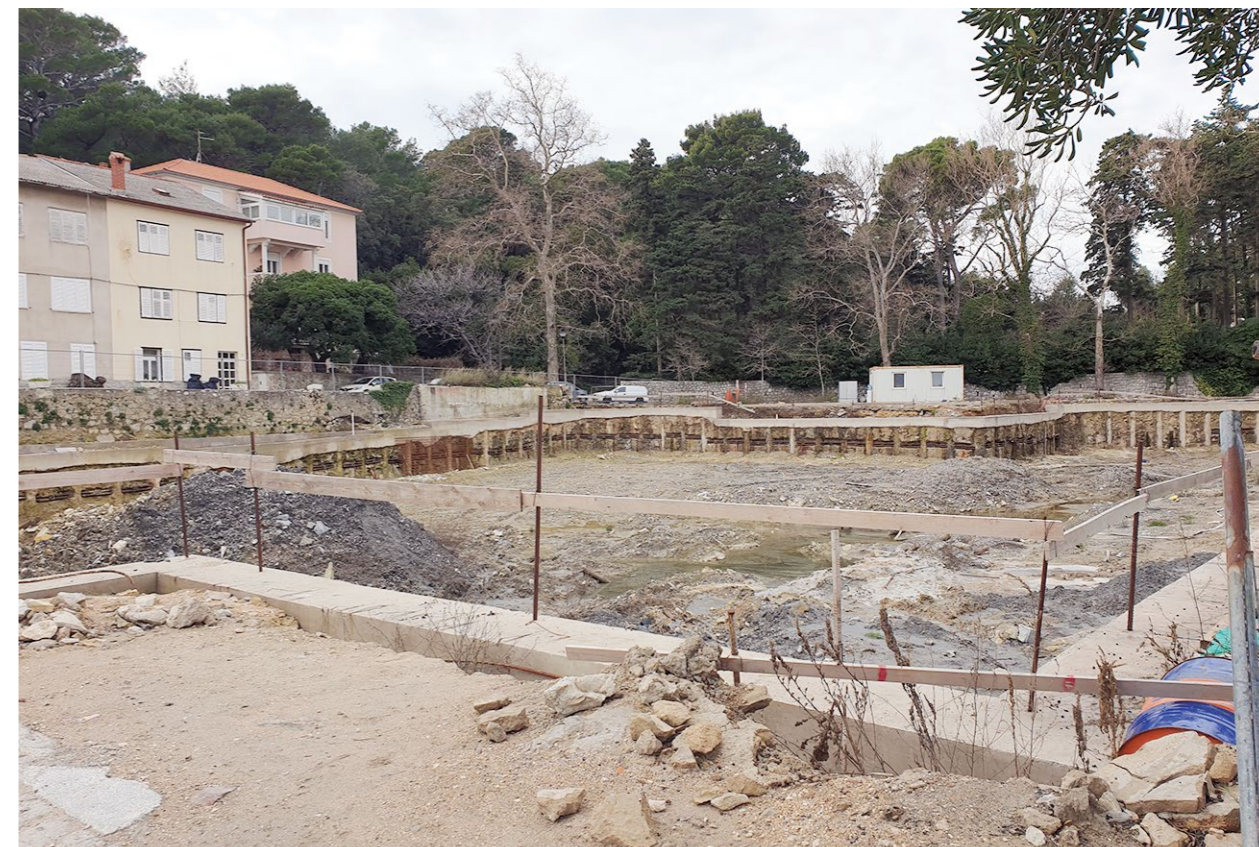
Pogled s jugoistoka na gradilište na k. č. 140/3, k. o. Rab – Mundanije (foto: I. Radić Rossi) View from the southeast of the construction site at cadastral parcel 140/3, Rab – Mundanije (photo: I. Radić Rossi)
